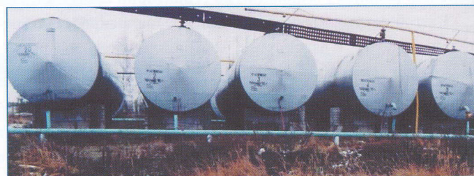
Фото. 1. Склад ГСМ ЗАО «ТЗК «Славнефть-Туношна»
